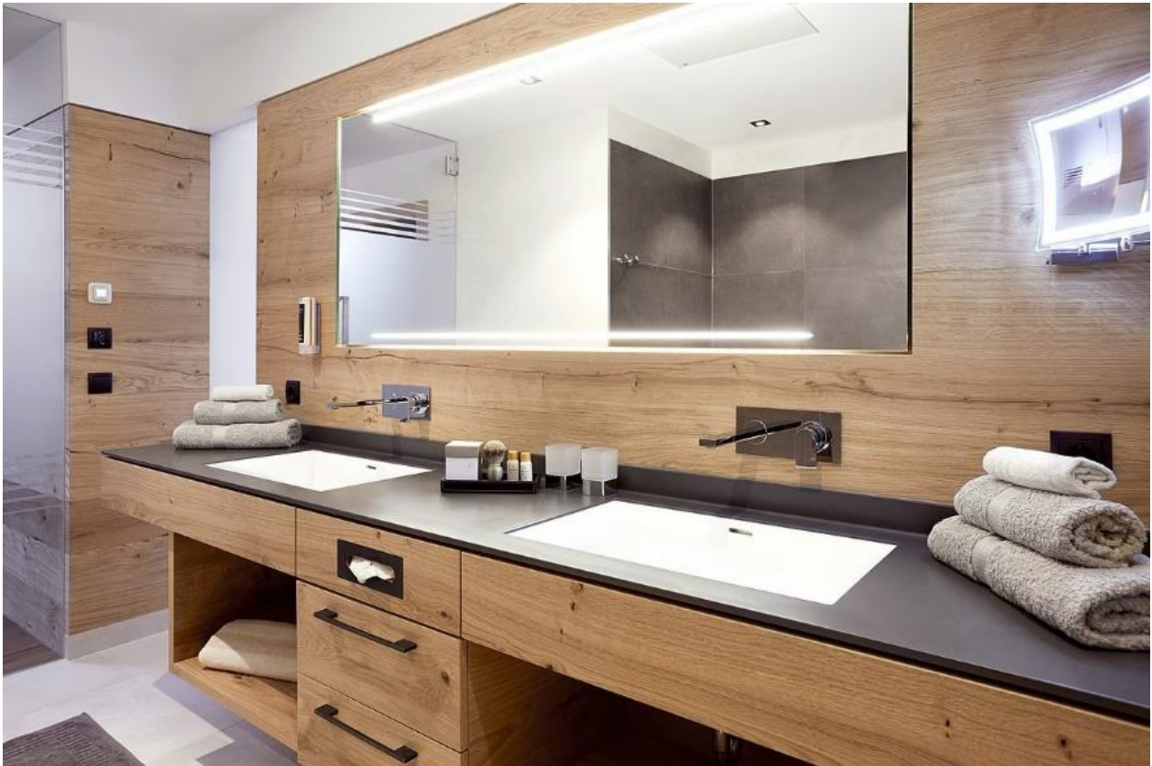
Bild 1: eine moderne, hocheffiziente Infrarotheizung fügt sich harmonisch in zeitgemäße Raumgestaltung ein. Im oberen Bereich des Spiegelbildes ist ein Teil eines flächenbündig verbauten Infrarotpanels in Deckenmontage zu sehen.
